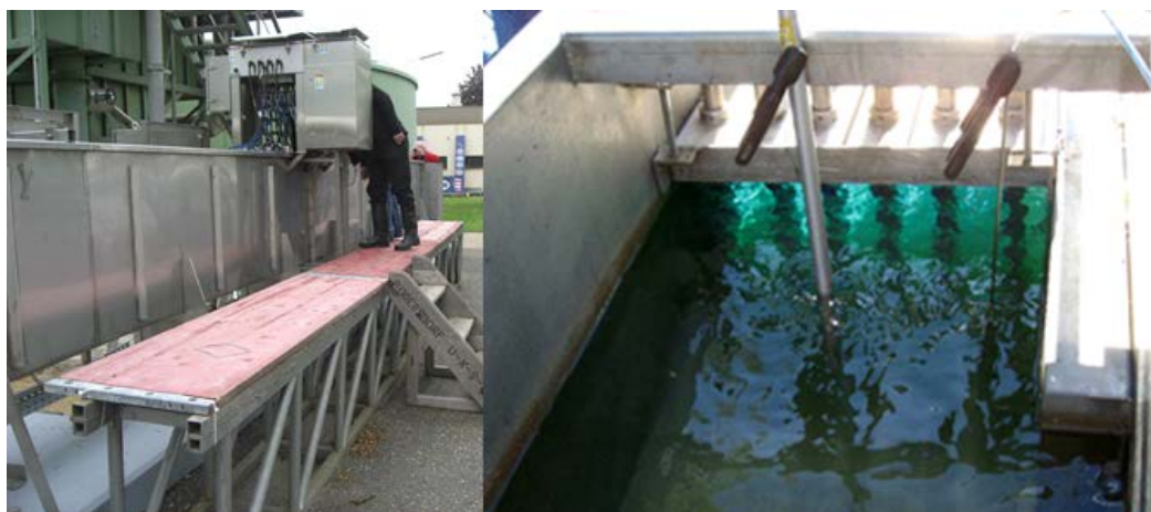
Abbildung 2: ARA Podersdorf UV-Desinfektionsanlage
