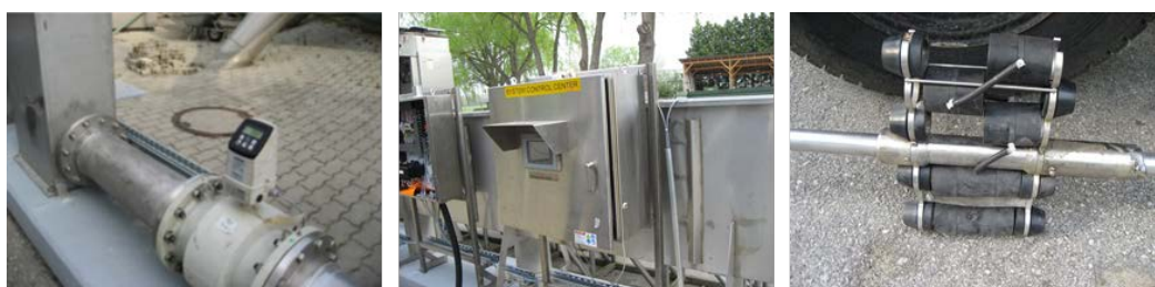
Abbildung 3: ARA Podersdorf UV-Anlage, technische Ausstattungen (von links): Messgerät für den Wasserdurchfluss, elektrischer Schaltkasten mit Mess- und Steuereinrichtungen, Einrichtung für die Reinigung der Quarzhüllrohre der UV-Strahler
